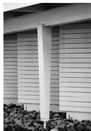
Philippe Meier, Ergänzung Gartenpavillon von Georges Addor / Extension to the garden pavilion by Georges Addor, Mies, Waadt / Vaud, 1994–1996
